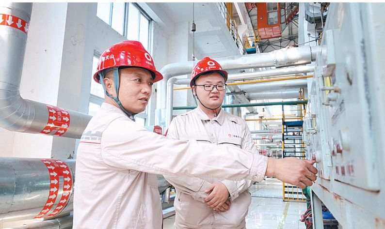
余热发电车间内，工作人员正在操作设备。⑥5
