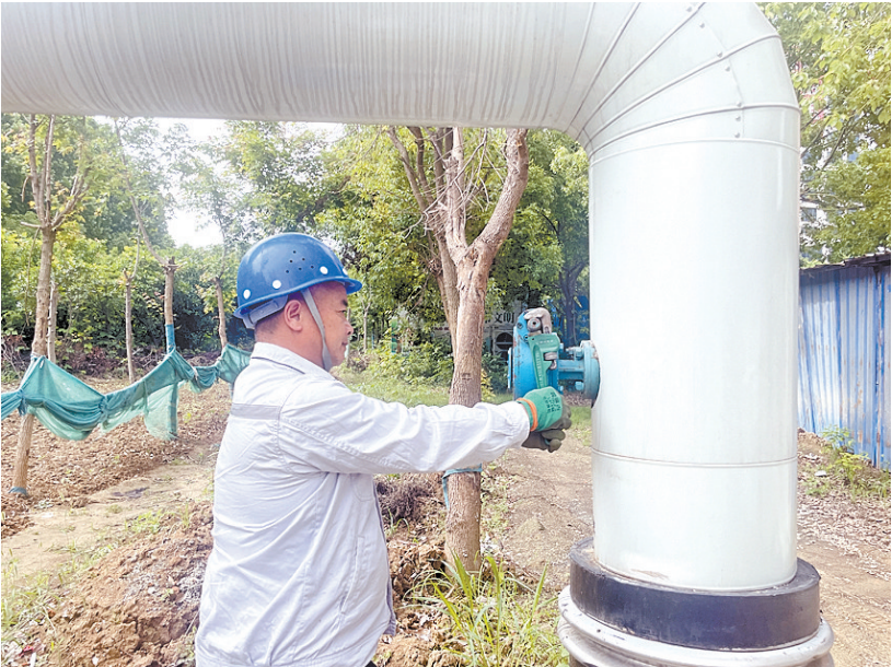
作为本地核心供热保供单位，驻马店热力公司肩负市中心城区60多家工业企业蒸汽保供任务。近日，该公司巡线运维人员坚守岗位，以细致巡检、精准调控筑牢供热保供防线，保障工业供热平稳有序运行。
