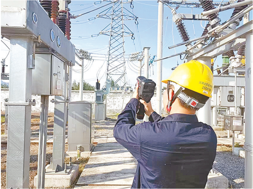
近日，国网泌阳县供电公司工作人员前往35千伏邓庄变电站，对变电设备进行测温，以可靠电力保障群众清凉度夏、企业稳定生产。⑥2 通讯员 马彩云 摄
