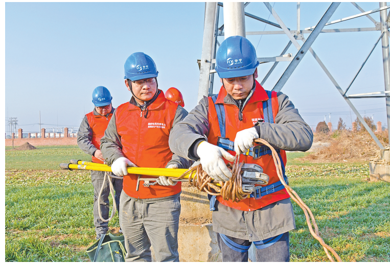
近日,国网西平县供电公司组织人员对35千伏柏管线01号杆塔电缆头进行加固处理,预防因电缆头脱落引起故障跳闸,切实提升供电能力,全力以赴确保供电安全稳定和居民生产生活用电。⑥2
