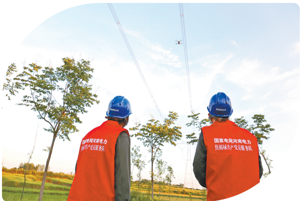
8月11日,国网泌阳县供电公司焦裕禄共产党员服务队队员运用无人机对特高压线路进行巡视。⑥6 通讯员 王超 摄
